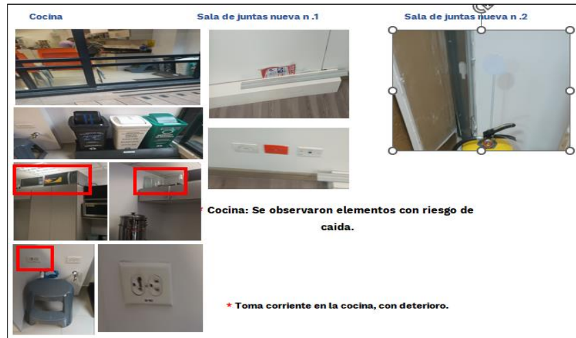
Imagen No. 6. Fotografía Posible riesgo de caída y electrónico.
